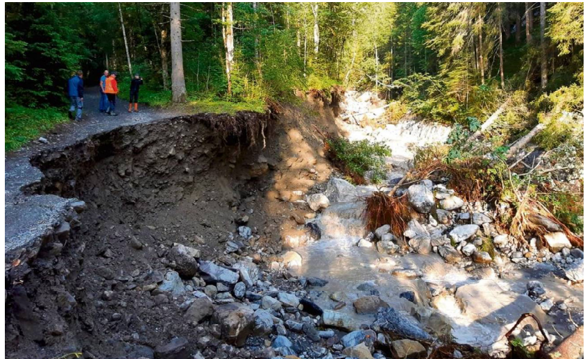
Weggespült: Der Fahweg von den Simmenfällen zum Rezilberg wurde von den Fluten auf einer Länge von 20 Metern zerstört.
