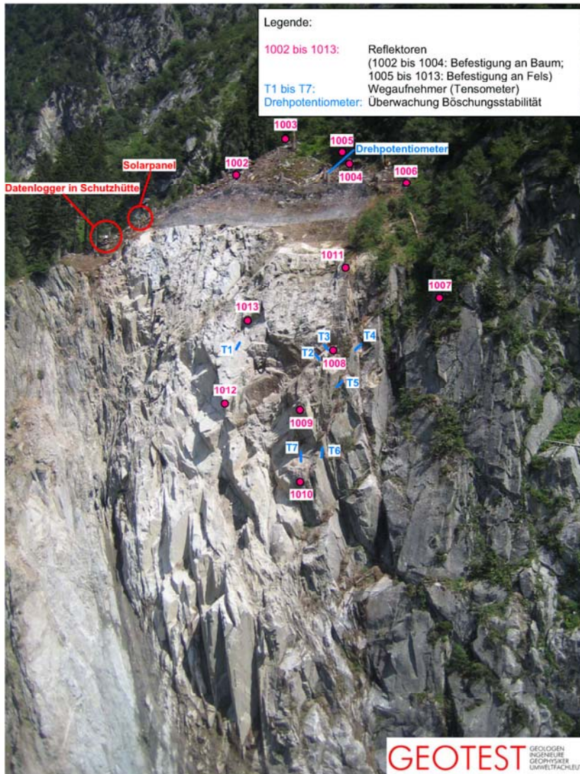
Bild 4: Ansicht der Felsoberfläche nach der Sprengung mit installierten Geräten zur Überwachung. Die Tele-Tensometer sind permanent aktiv und mit einem Datenlogger verbunden. Die Energieversorgung des Loggers und der Messgeräte erfolgt über ein Solarpanel. Die Messdatenübertragung erfolgt über Mobiltelefon, die Daten können online abgerufen werden. Bei einer Grenzwertüberschreitung wird automatisch Alarm per SMS ausgelöst.
