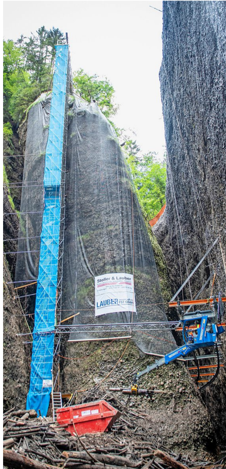
Der Zugang in die Schlucht ist für die Arbeiter über diesen 50 Meter hohen Gerüsturm möglich. Foto: Marcel Bieri
