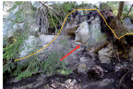
Ausbruch (unterhalb orangener Linie). Offenkundig ist das nächste, durch eine offene Kluft vom Felsverband gelöste Felspaket (roter Pfeil zeigt auf die offene Kluft).
