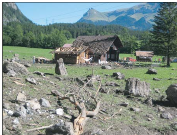
Sturzablagerungen und stark beschädigtes Haus im Hintergrund.
