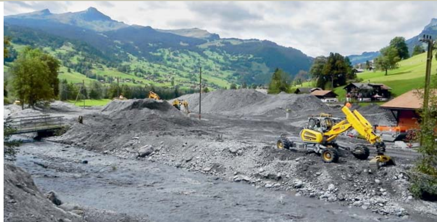
Abb. 2: Geschiebeentnahmen an der Schwarzen Lüttschine im Bereich Mättenbergbrücke in Grindelwald nach den Flutwellen im Jahr 2011.
